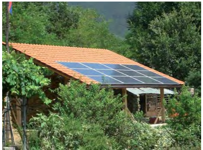
Impianto fotovoltaico da 2,52 kWp realizzato in modalità totalmente integrato
