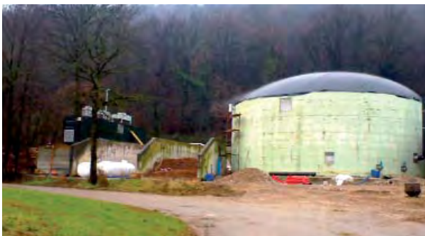
Lago di Garda, pot. elettrica installata: 190 kw: impianto "Agrigas Farmer" in completamento, attiguo ad allevamento di 220 capi bovini per trattamento reflui e sansa d'oliva locale
